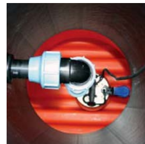
PW Easy -pumpstationen sedd uppifrån.
