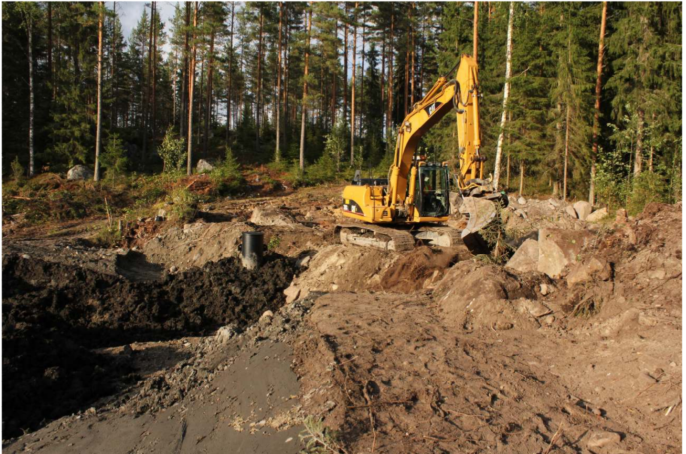
Kuva 13. Tässä patorakennuskohteessa kaivon tuloputki olisi saanut olla pidempi, jotta patokaivo olisi saatu asemoitua kaivinkonetta kantavan kivennäismaapenkereen puolelle. Märkä ja elastisesti liukuva rahkaturve ei antanut kaivolle parasta mahdollista vastatukea kosteikon puoleisen patoluiskan puolelta.
